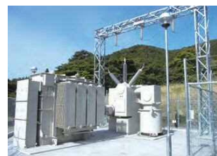
66kV 特高受変電設備
