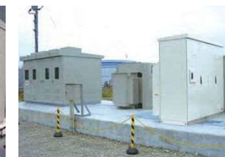
パワーコンディショナー(太陽光発電所)
