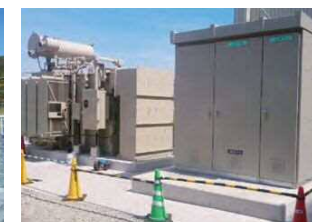
22kV 特高受変電設備
