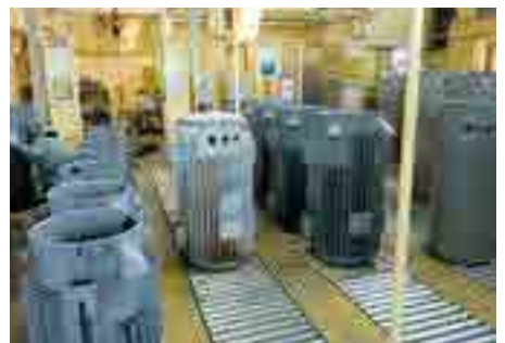
変圧器部分修理工場 Transformer parts repair facility
