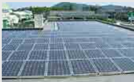
本社屋上の太陽光パネル
